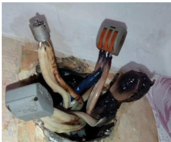
Рис. 3. Пример плавления изоляции.
