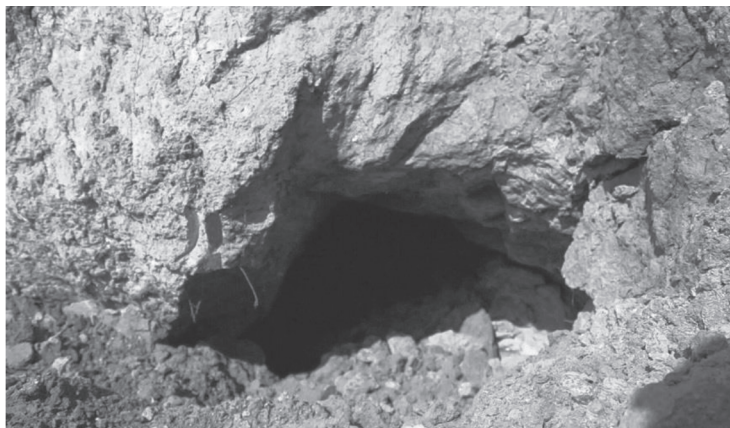
Рис. 4. Вторичная полость, образовавшаяся в результате обрушения пермских глин в первичную полость, находящуюся в нижележащих пермских гипсах (окрестности г. Павлово Нижегородской области, 2013 г.). Кадр видеосъемки, выполненной М.В. Леоненко.
