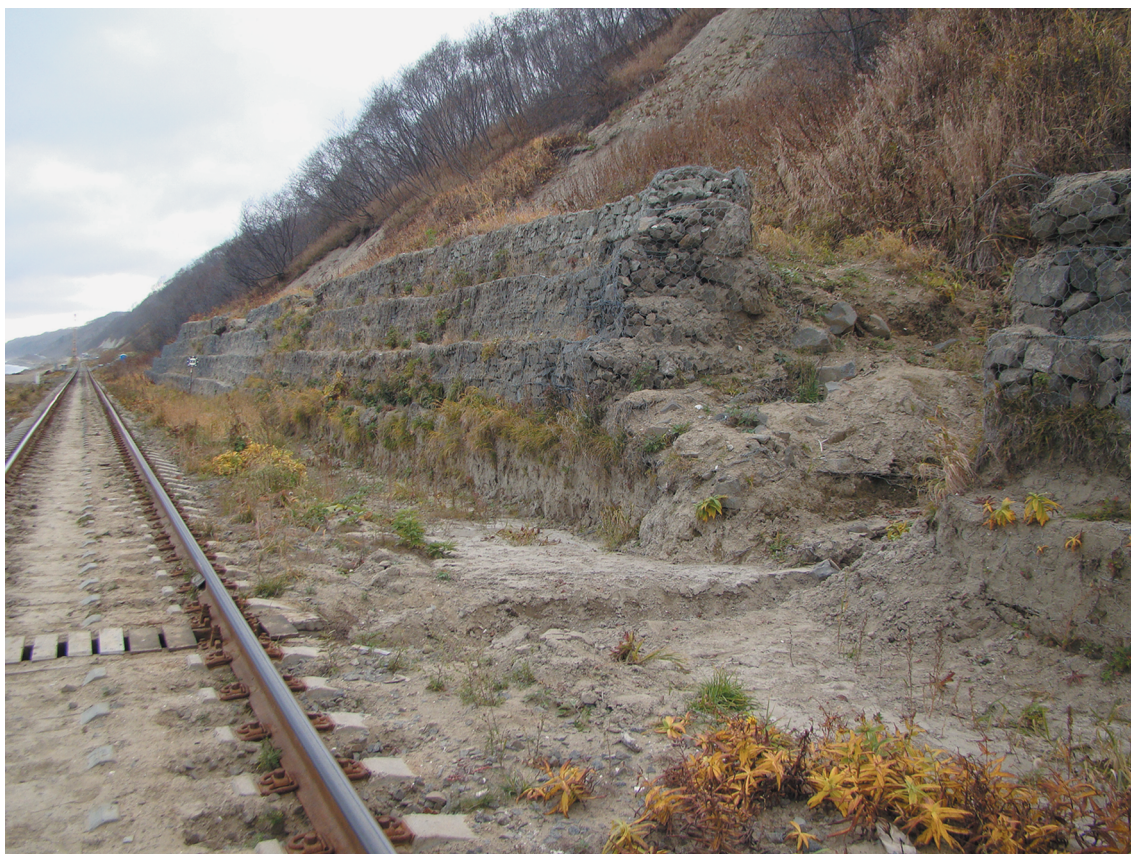
Рис. 1. Противооползневая подпорная стена, разрушенная склоновым селем.
