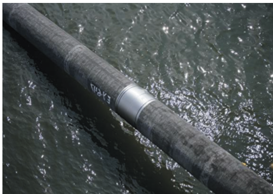
Рис. 3. Фотография размытой оголенной части подводного морского газопровода.
