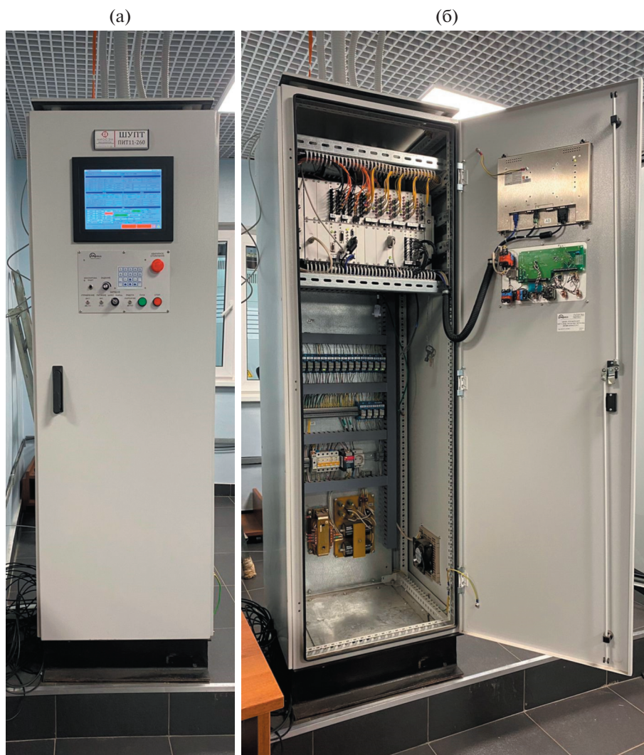
Рис. 7. Внешний вид шкафа управления источником тока: а – вид снаружи; б – вид изнутри.
