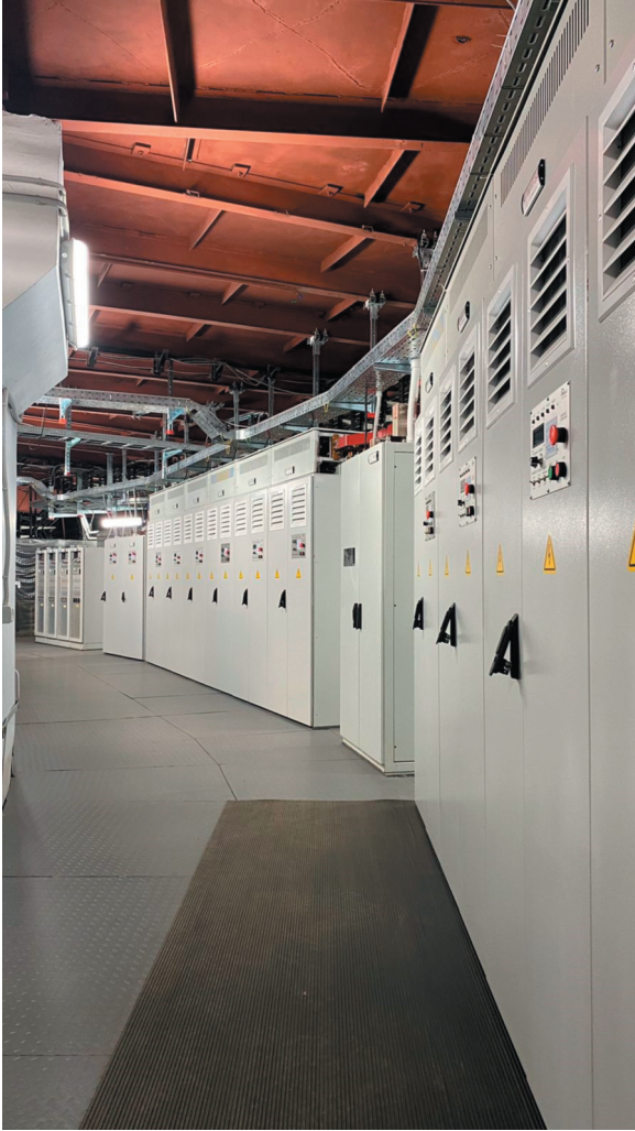
Рис. 6. Внешний вид ПИТ11-260, установленного на цокольном этаже Бустера.
