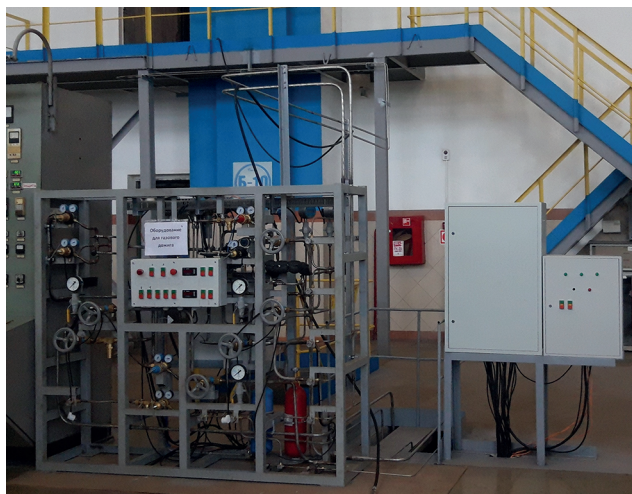
Рис. 7. Внешний вид блока управления установки ДГПП на ТЭС-16 филиала ПАО «Мосэнерго»
