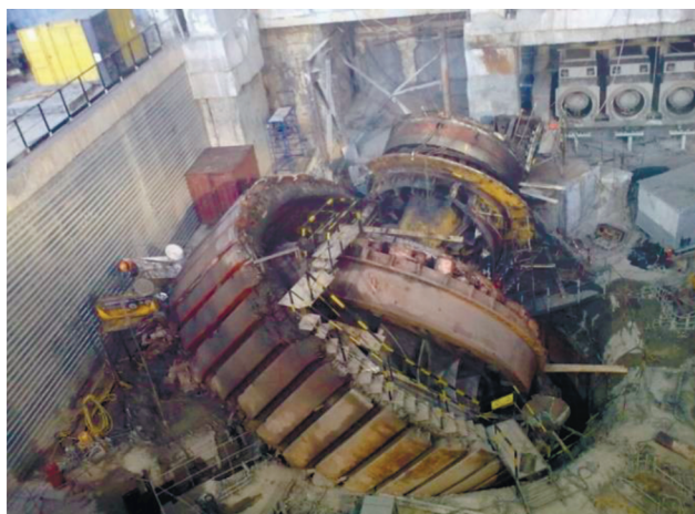
Рис. 4. Вид гидроагрегата ГА-2 после аварии.
