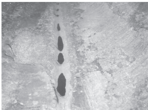
Рис. 1. Щелевая коррозия в технологических трубопроводах.
